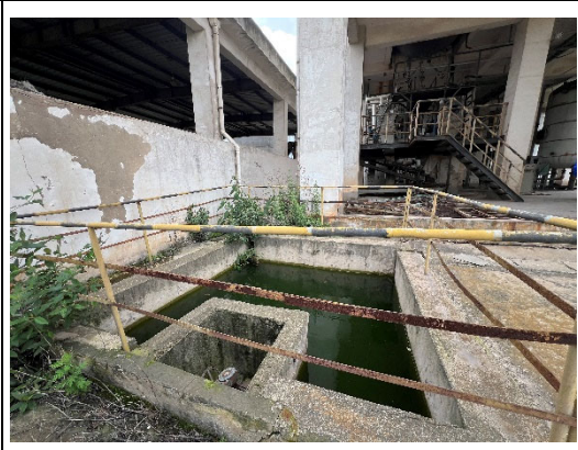
场地初期雨水收集池
